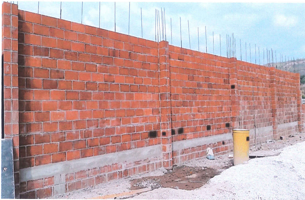
Muro perimetral, levantado de pared ubicado a la par del Edificio de Talleres.
