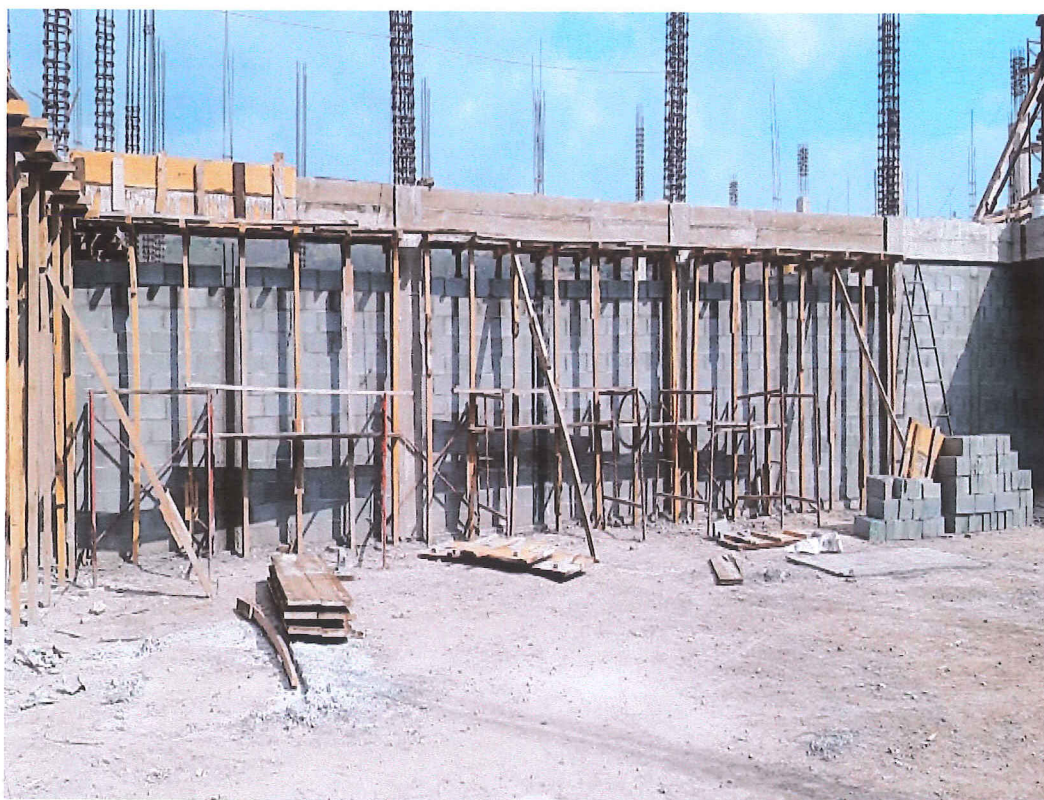
Edificio de Talleres: Taller Multifuncional, desencofrado de viga y levantado de pared.
