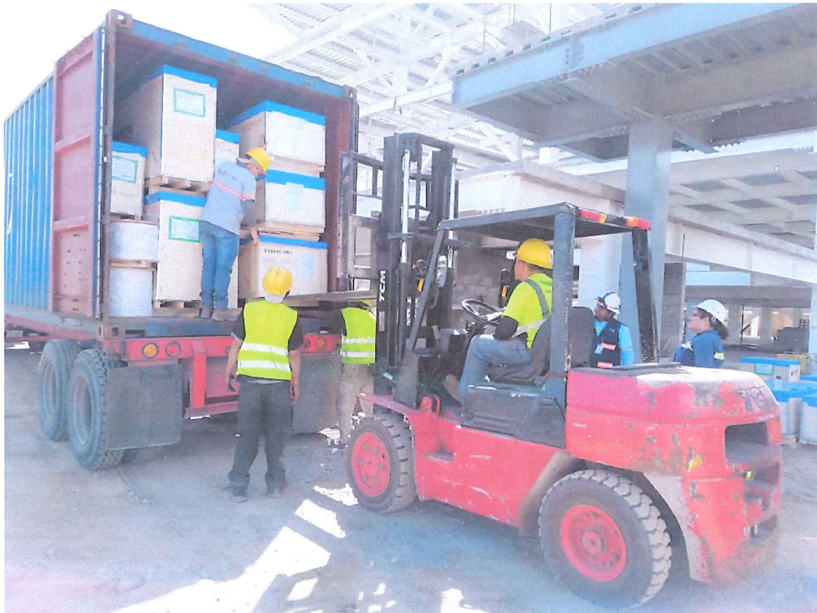
Descarga de elevadores de sótanos y edificio administrativo.
