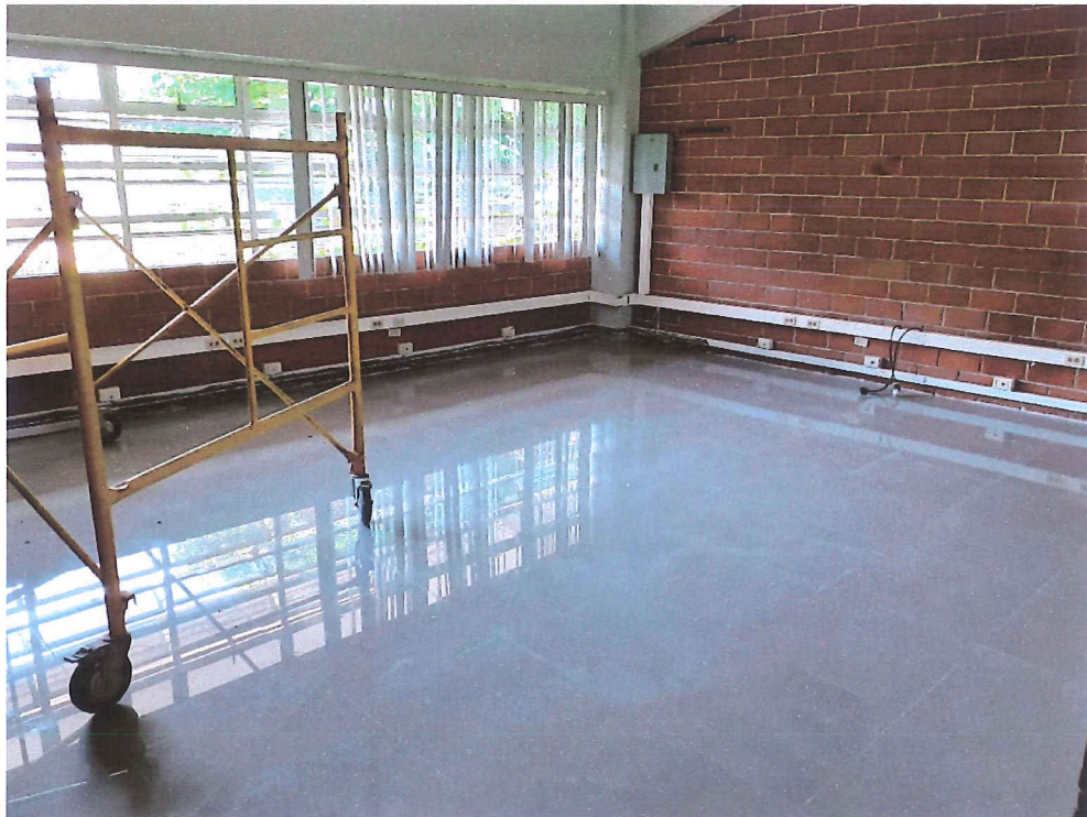
Colocación de piso de porcelanato y desmontaje de zócalos de madera en aulas de las torres 1 y 2 existentes
