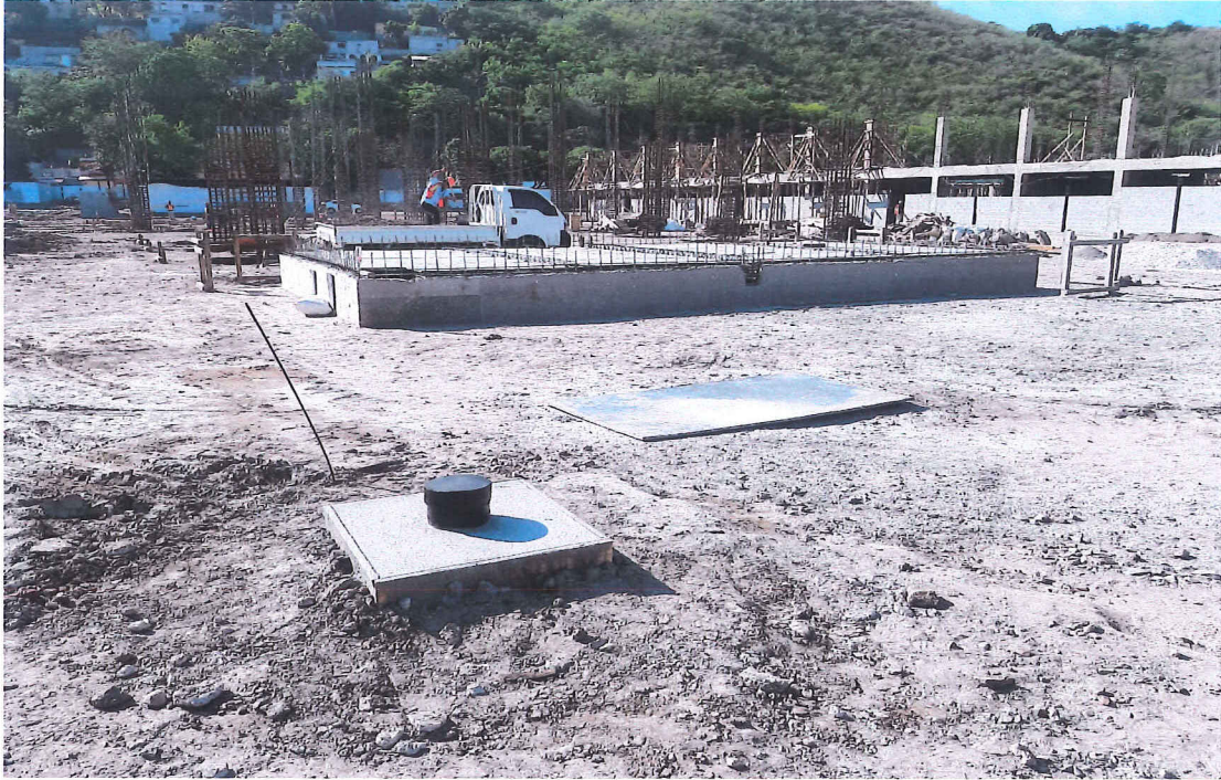
Pozo de Agua: Sello sanitario.
